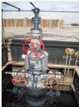
CCS-1 の坑口装置
